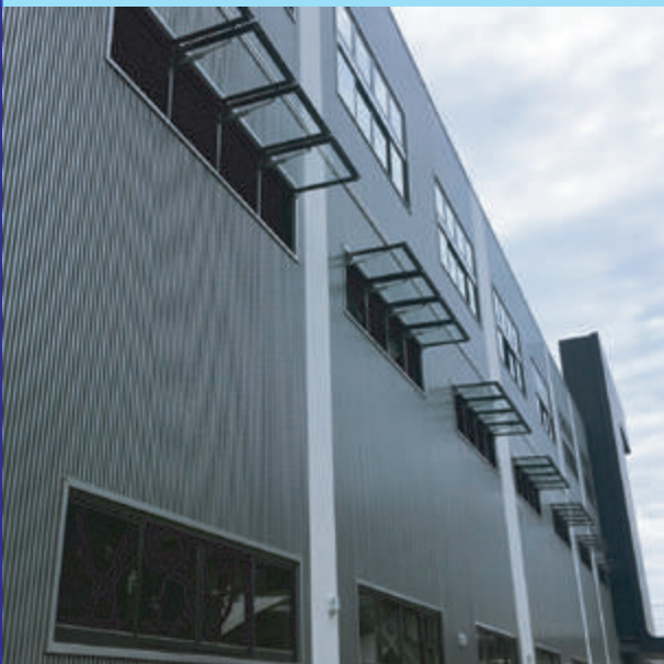
@廠房。合乎消防排煙，具日常通風及區域連動控制等功能。
