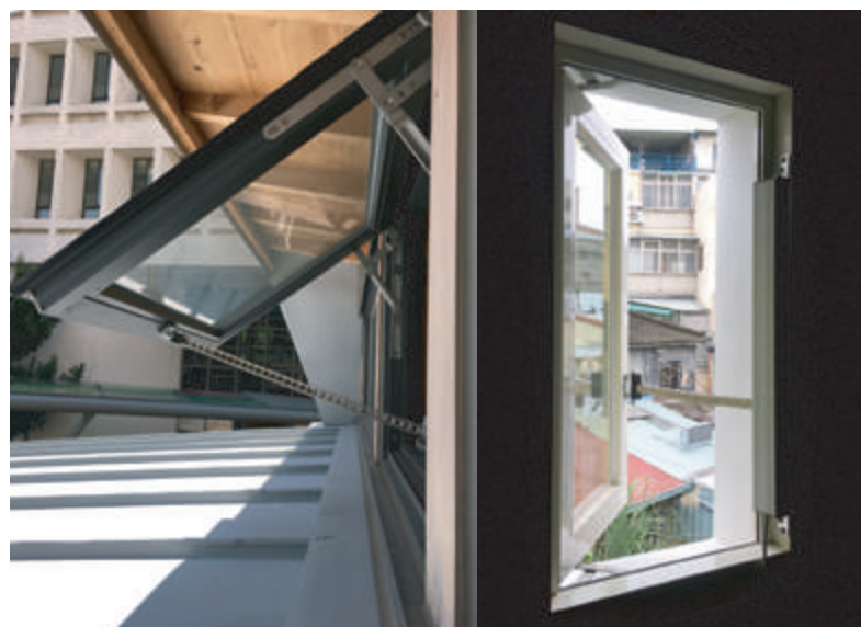
▲ @ 校園綠建築展示間，可開啟高處氣窗進行日常通風。
