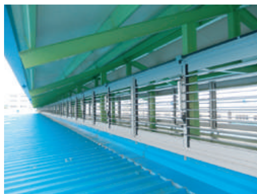
@南韓廠房。開啟太子樓的電動百葉窗，加強廠內自然通風。
